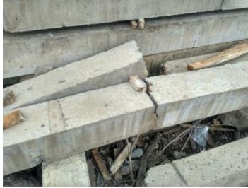
Gambar 1.1 tiang pancang retak
