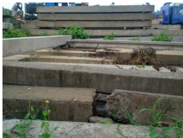
Gambar 1.3 tiang pancang roboh
