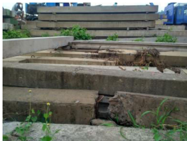
Gambar 1.3 tiang pancang roboh
