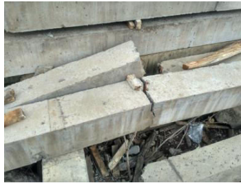
Gambar 1.1 tiang pancang retak
