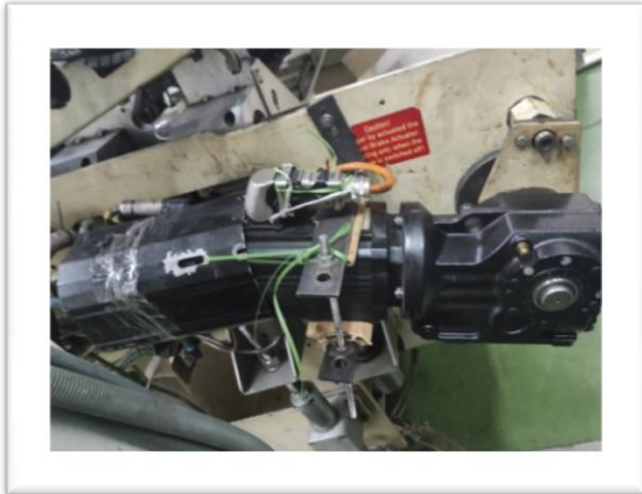
Gambar Perbaikan Soket Motor Yang Goyang
